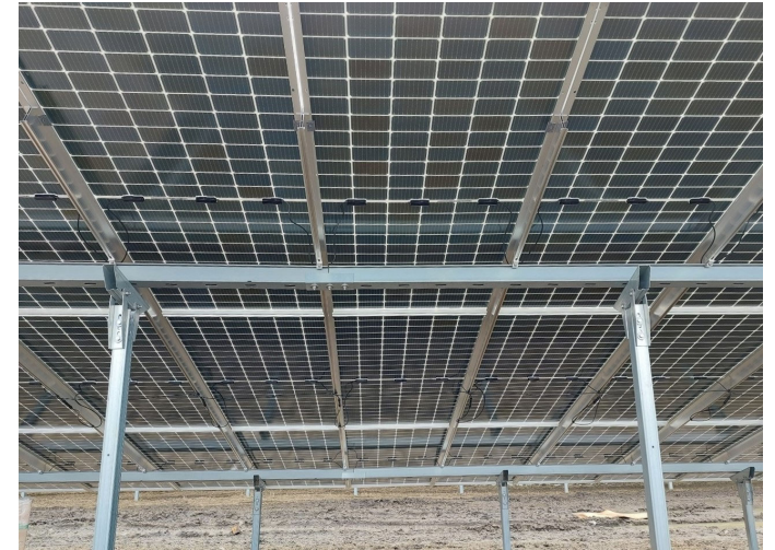
PVA Mühlhausen – Rückseitige Ansicht eines Modultisches: Rückseitig auftreffendes Licht trägt zum Ertrag bei. Optimierung des Gesamtdesigns (Reihenhöhe, Abstände, Träger, etc.) möglich Quelle: EnBW T-PDP
